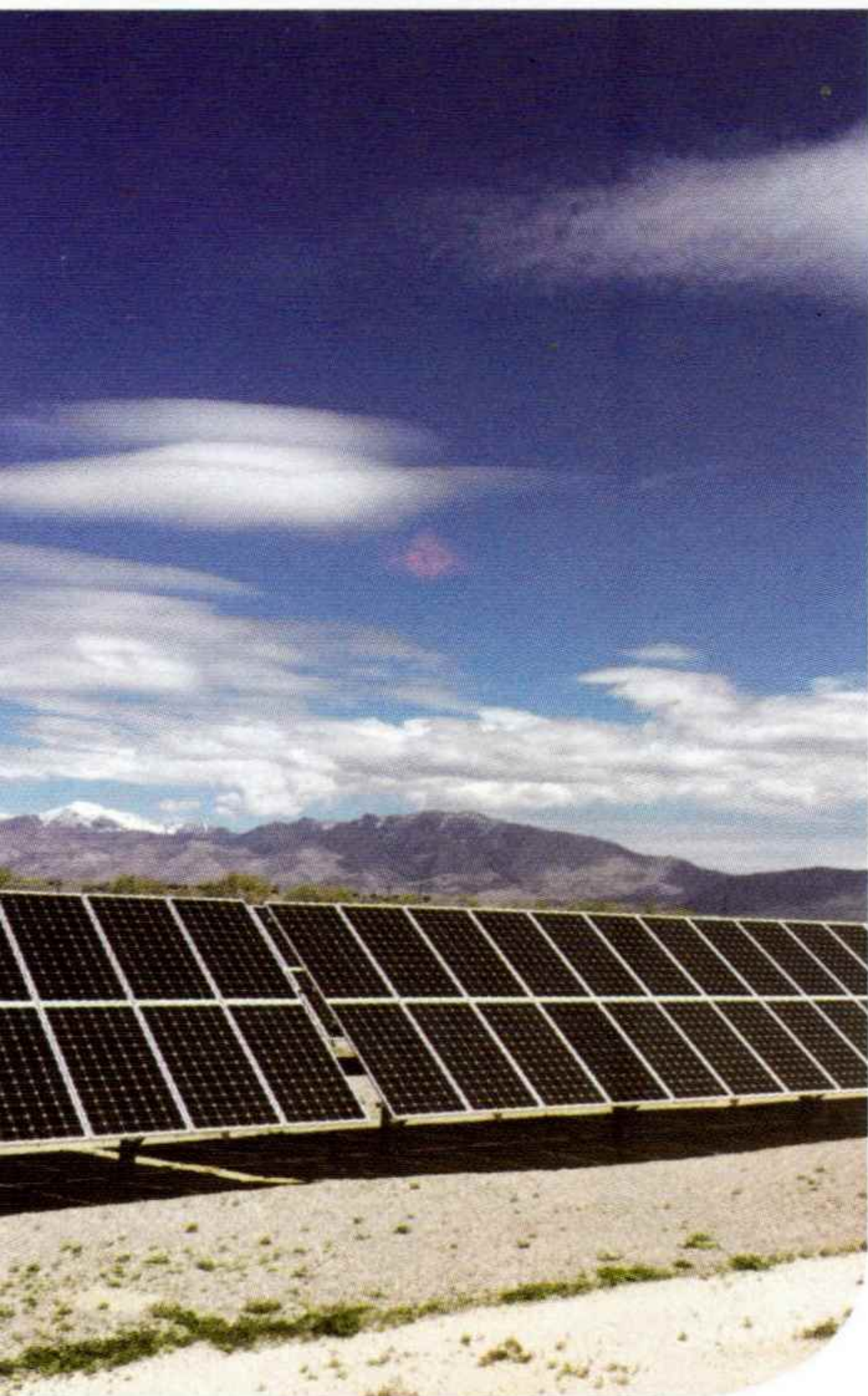
Modulos solares de Heliene en la base militar de Dugway, instalados por Isla Power en Utah (EE.UU.)
